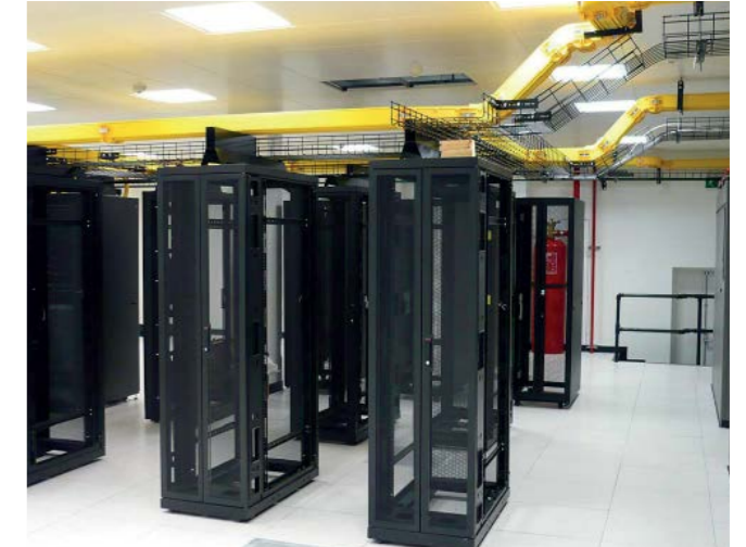
Installation typique de système de management de cuivre et fibre en hauteur avec des fixations customisées sur le toit des baies
